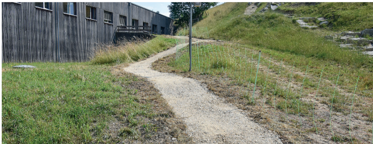
Auch bei der Passage um die Sporthalle wurde ein Untergrund installiert, welcher auch bei Morast zu befahren ist.
